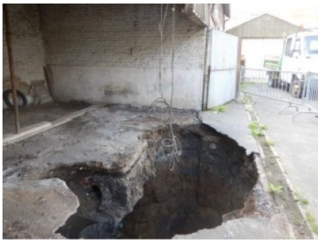
Effondrement à Beaurains Photo DDTM
