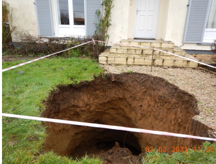
Effondrement à Ecoust Saint Mein Photo DDTM
